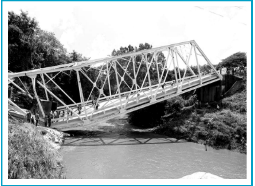
El Puente de Guisilá, en Chontales, colapsó, -se cayó-, tras ser impactado por un camión de carga. En forma jocosa los lugareños se mofan del Ministro del MTI Oscar Mojica, por ser ésta su obra insigne, "le puso cuajadas y piedras", no hierro ni cemento.
